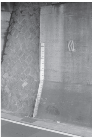
画像 7 水位計 (西側壁面) 3mまで目盛表示
